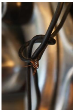
Abbildung 28: Kaputtes Kabel (eigenes Foto)
