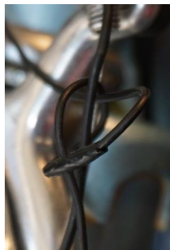
Abbildung 29: Mit Isolierband geflicktes Kabel (eigenes Foto)
