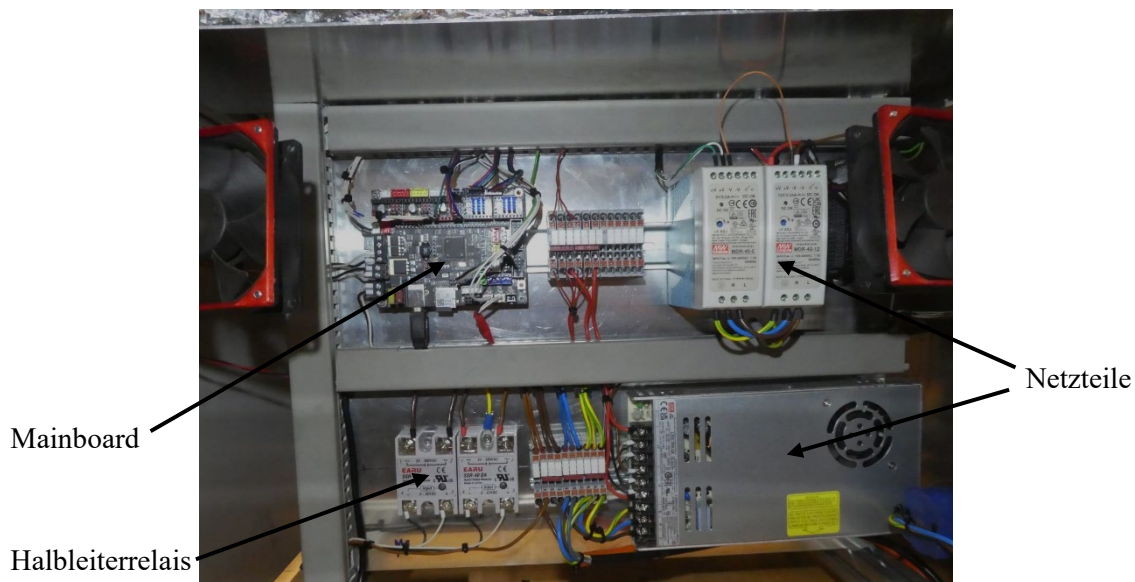
Abbildung 6-17: Unterer Teil der Elektronik
