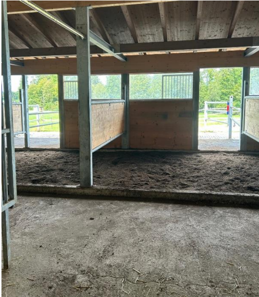
Abb.14: Liegeflächen mit «Waldboden»-Einstreu. Im Hintergrund sieht man die Tür, die zum Auslauf führt (eigenes Bild)
